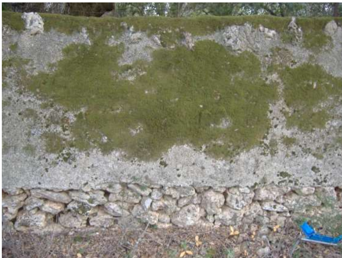
Figura 16 - Discontinuità nel muretto
